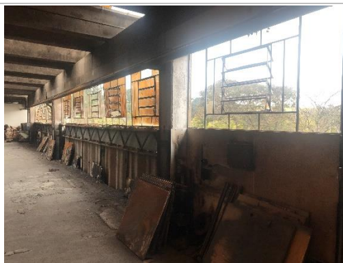
Vista Geral – Galpão / Produção Área incendiada
