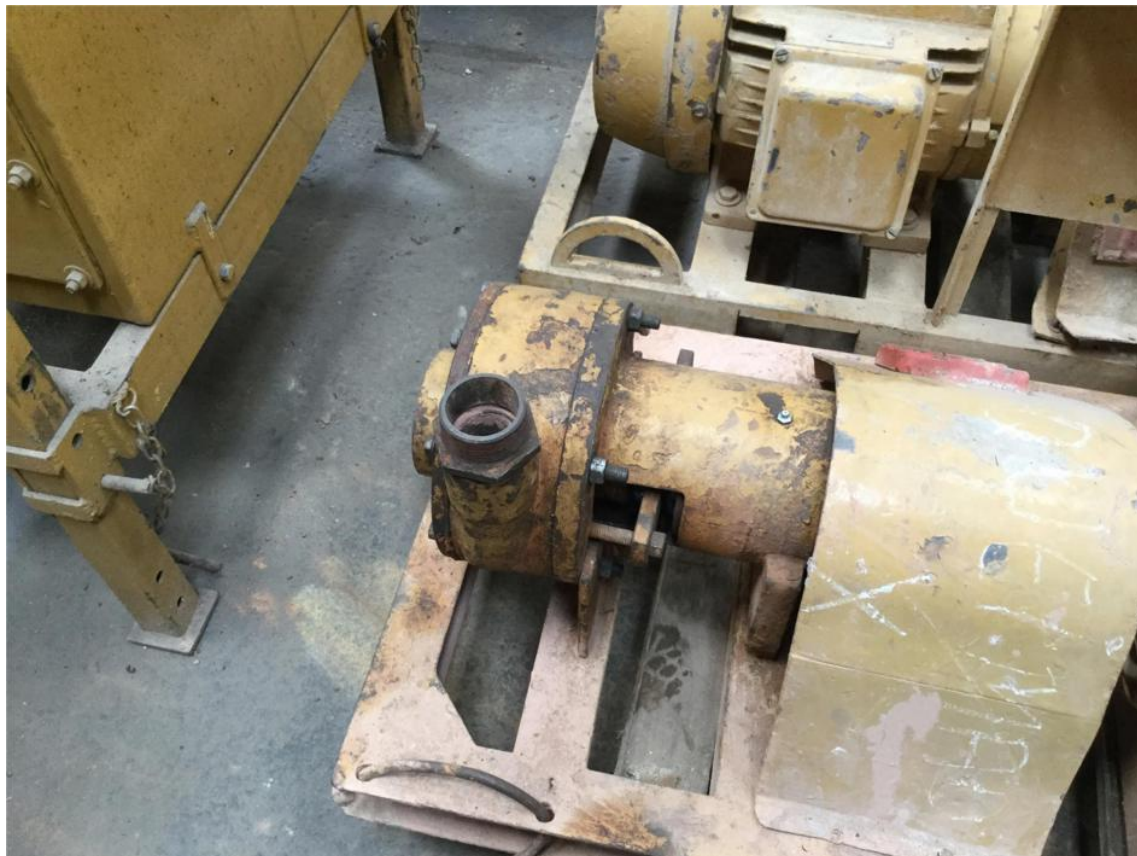
Detalhe da conexão entre bomba e tubulação hidráulica
