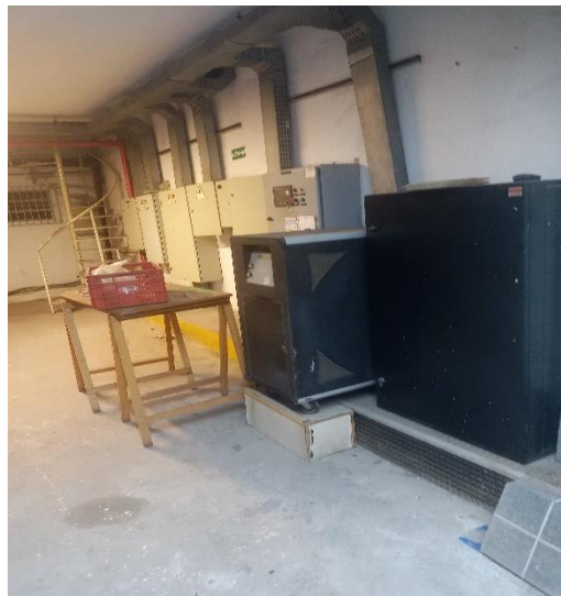
Vista de area de máquinas
