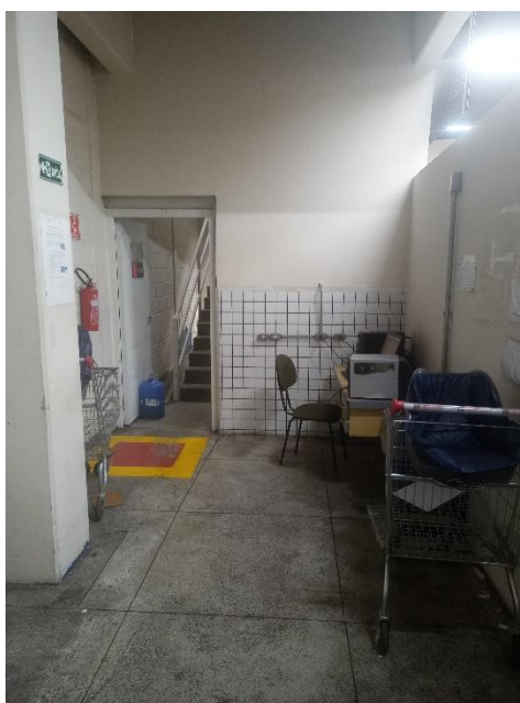
Vista de área de máquinas
