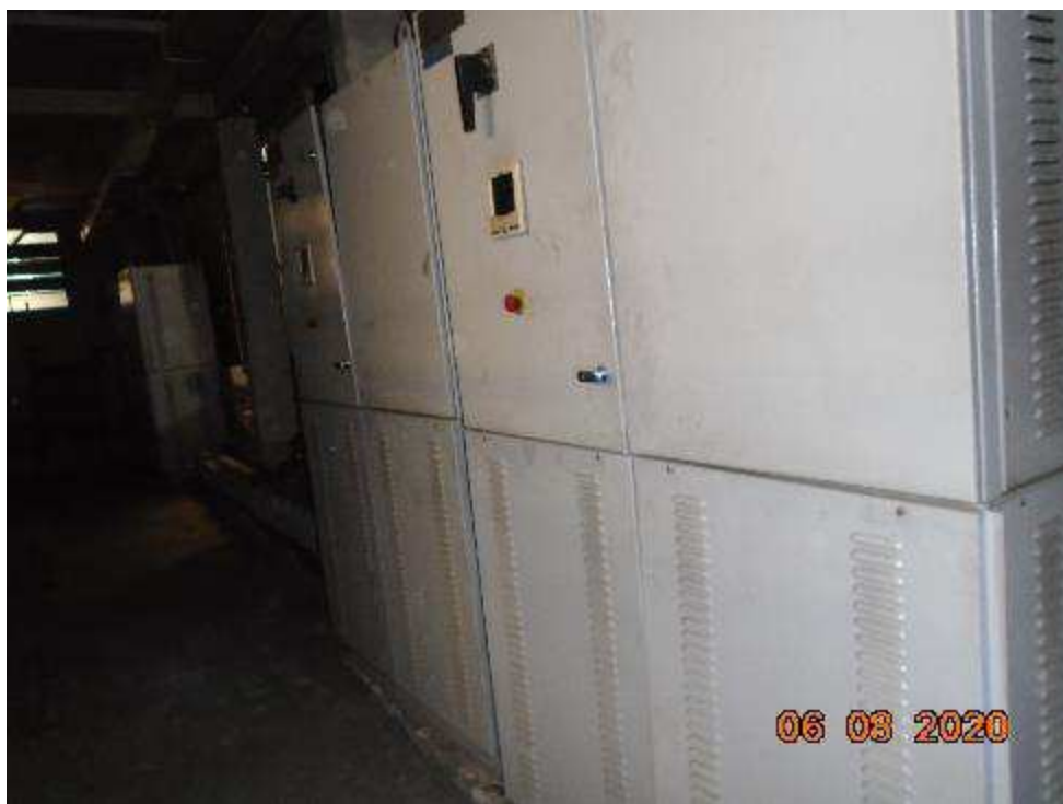
S.E. INTERNA PAINES ELETRICOS
