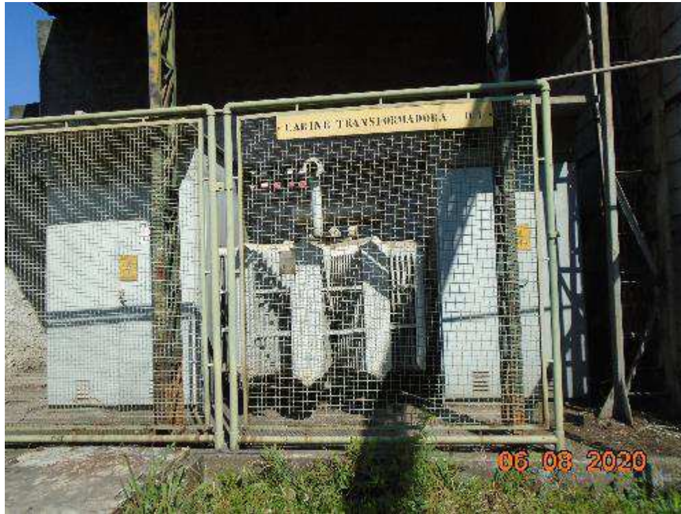
S.E. ENTRADA DE ENERGIA TRANSFORMADOR 1000KVA
