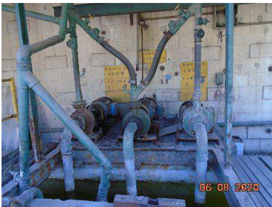
BOMBA DE ÁGUA
