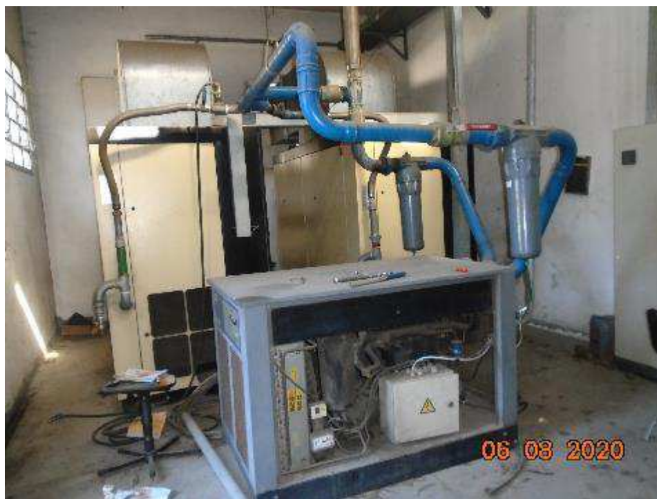
SALA DOS COMPRESSORES
