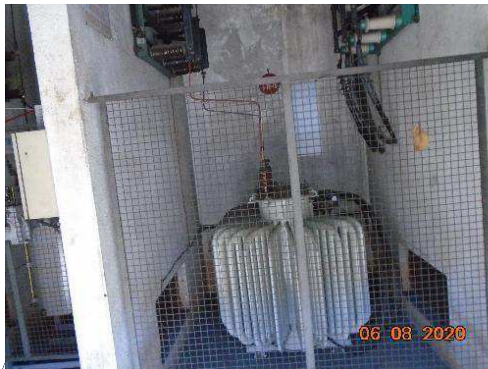
TRANSFORMADOR SIEMENS 300 KVA
