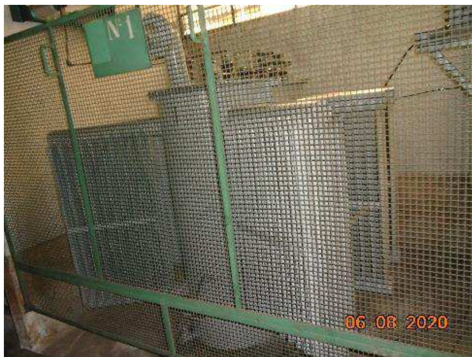
S.E. INTERNA TRAFODINI 1.400KVA
