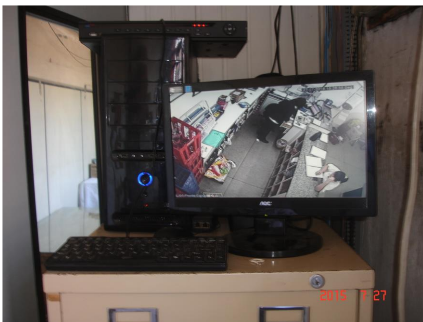
Vista 2 GERAL SALA GERÊNCIA / SERVIDOR
