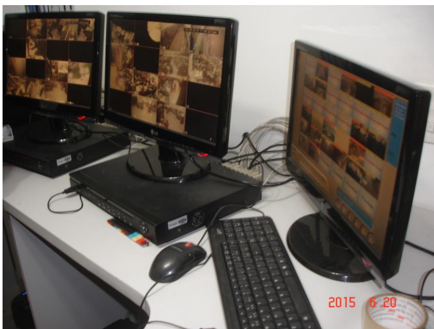
Vista GERAL 1 da SALA DE MONITORAMENTO
