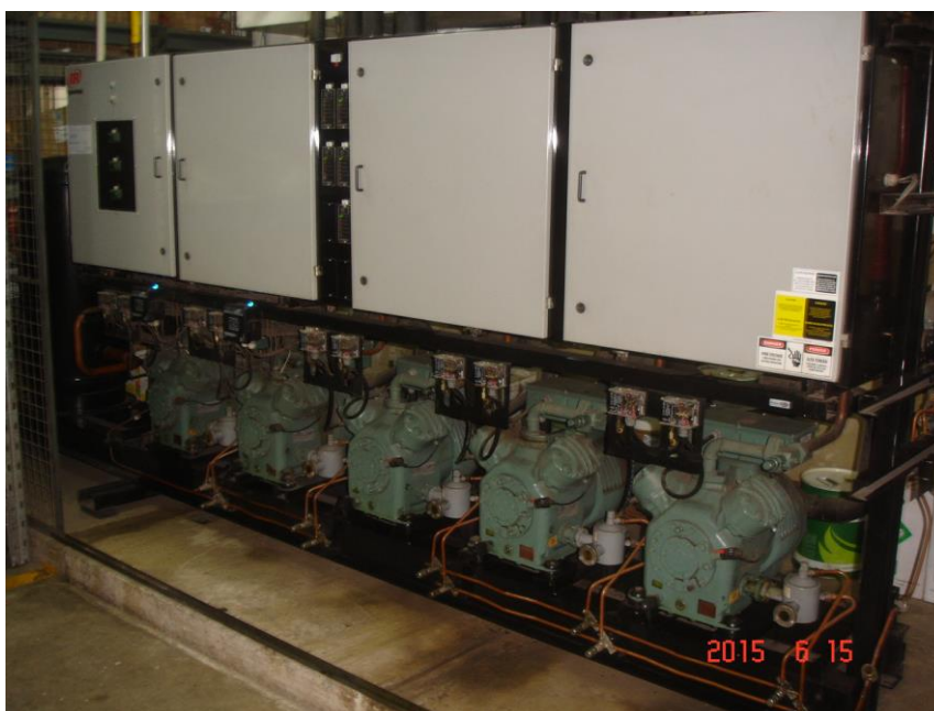
Vista GERAL 1 da CASA DE MÁQUINAS. Patr. 00328
