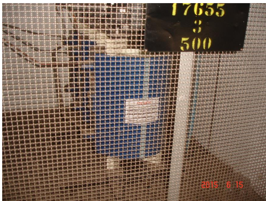
Vista do TRANSFORMADOR TRIFÁSICO, marca CONTRAFO, Potência 500 KVA, número 039741. Patr. 00335
