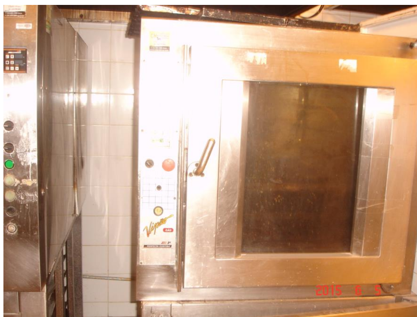
Vista do FORNO INDUSTRIAL, marca PERFECTA. Patr. 00125
