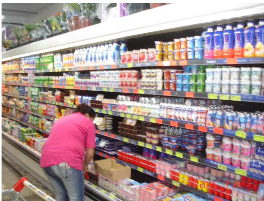
Vista do CONJ. DE REFRIGERAÇÃO DE LATICÍNIOS (IOGURTE, MASSAS) FIXO NA PAREDE, marca ARNEG BRASIL, contendo 03 módulos conjugados. COMPR. TOTAL 8,75 m X ALTURA 2,10 m.
