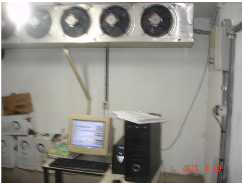
Vista GERAL 2 da CASA DE MÁQUINAS. Patr. 00738 a 00741
