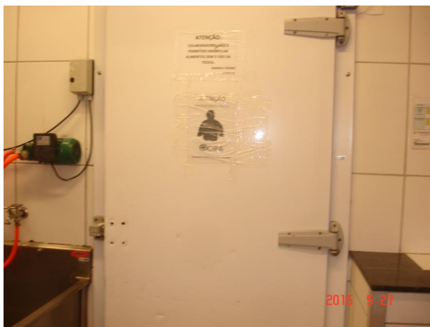
Vista da CÂMARA FRIA PARA CARNE CONGELADA. Patr. 00100
