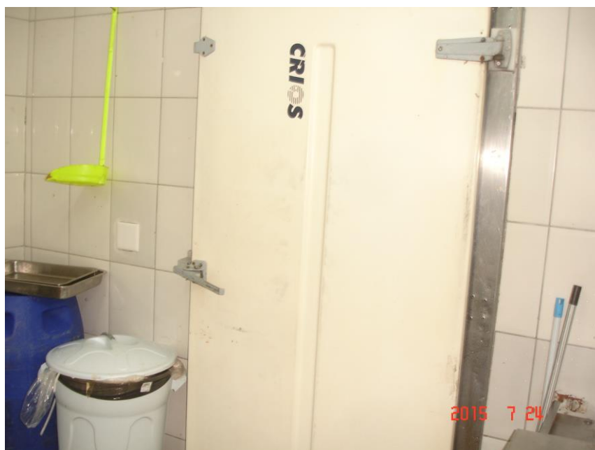
Vista da CÂMARA FRIA, medindo 3,00 m x 2,60 m x 3,00 m (C x L x H), com 1 evaporador MACQUAY com 04 ventiladores, Patr.1756
