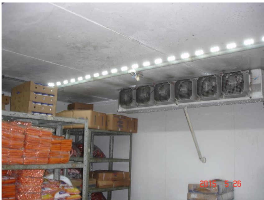
Vista da CÂMARA FRIA medindo 5,70 m x 4,80 m, com 1 evaporador e 06 ventiladores. Patr. 00078
