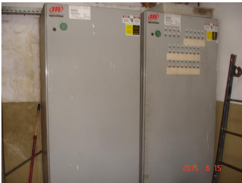
Vista GERAL 2 da CASA DE MÁQUINAS. Patr. 00328
