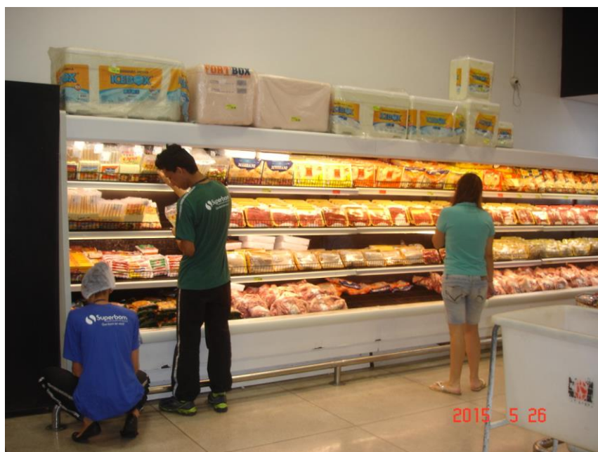
Vista do BALCÃO EXPOSITOR REFRIGERADO DE AUTO SERVIÇO, marca HUSSMANN. Patr. 00085
