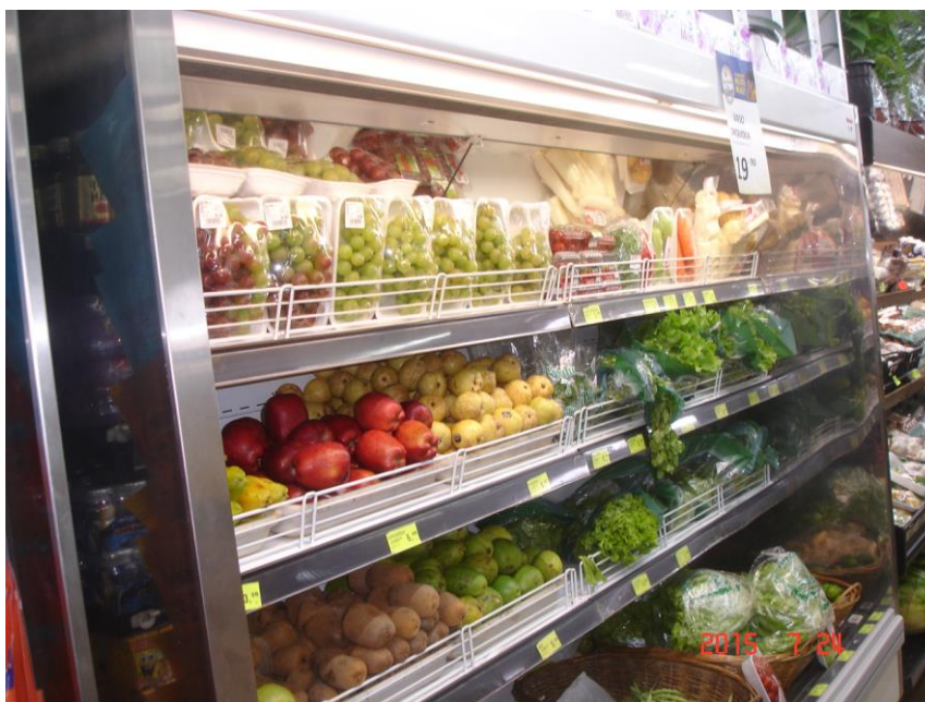
Vista da GELADEIRA DO HORTIFRUTI FIXO NA PAREDE, marca ARNEG BRASIL, modelo MANILLA 90 FV 2500/203, série 6102650001, comprimento 2,50 m x altura 2,10 m
