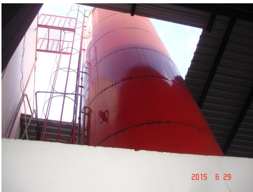
Vista da CAIXA D' AGUA METÁLICA, tipo cilíndrico vertical em aço carbono, capacidade 40 m³. Patr. 00737
