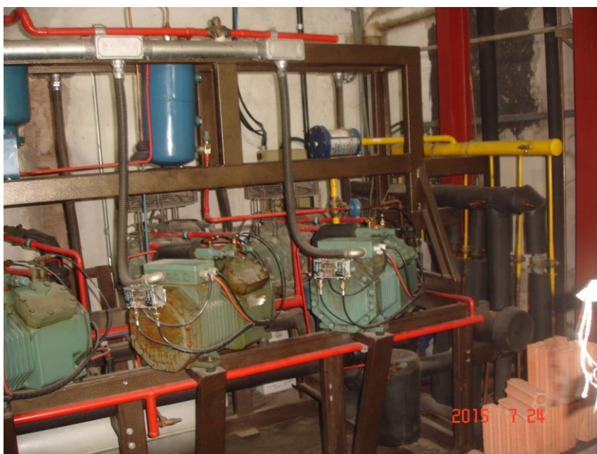
Vista do SISTEMA DE REFRIGERAÇÃO PARA RESFRIADOS E CONGELADOS, Patr. 1778
