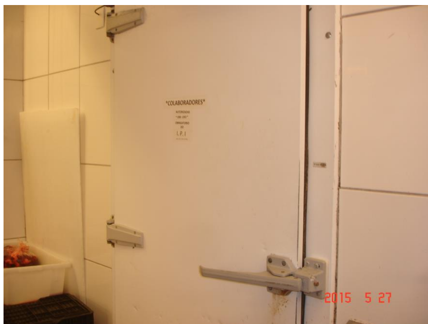
Vista da CÂMARA FRIA PARA CARNE RESFRIADA. Patr. 00099
