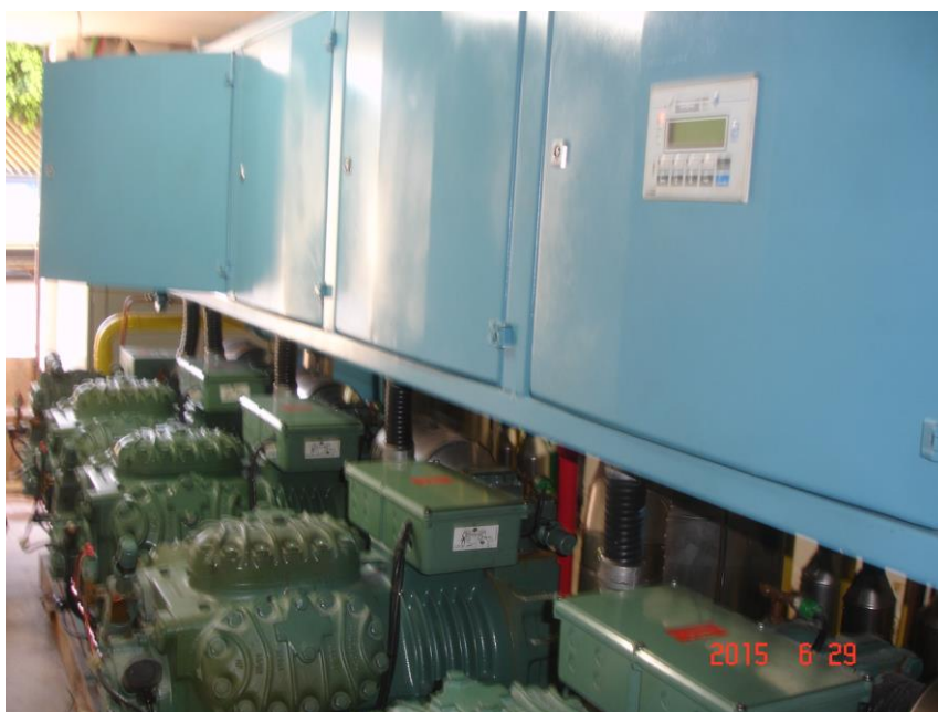
Vista GERAL 1 da CASA DE MÁQUINAS. Patr. 00738 a 00741
