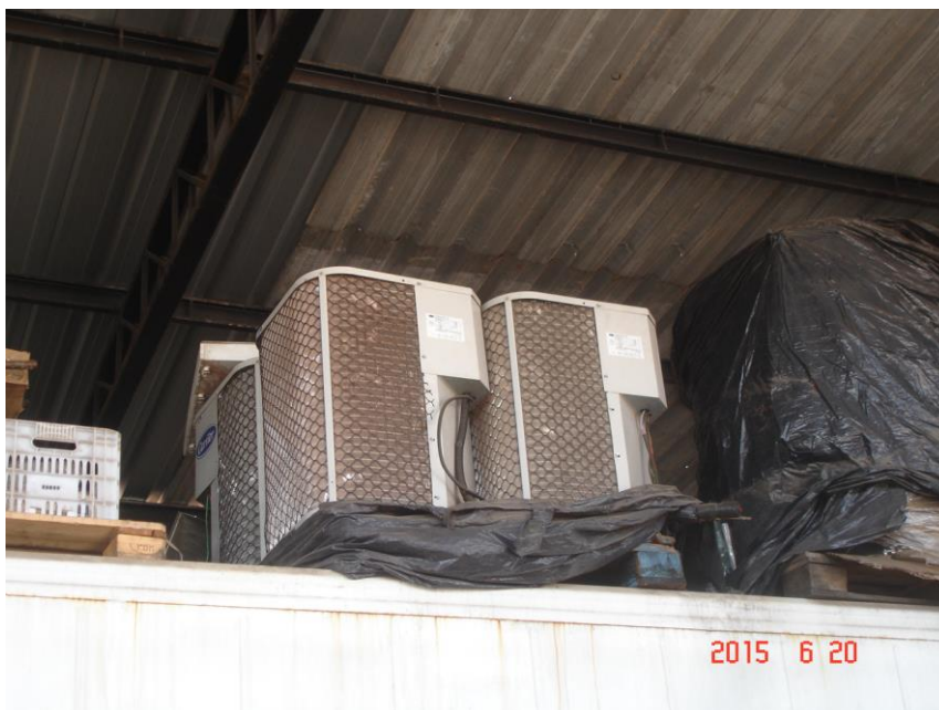
Vista dos Aparelhos de ar condicionado, marca CARRIER, 48.000 BTU. Patr. 00475 a 00478
