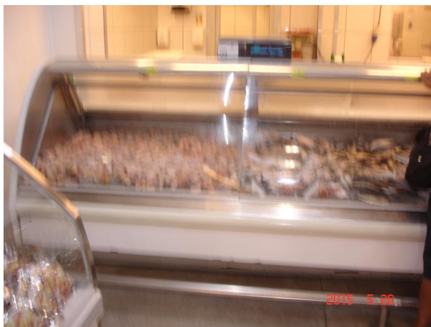
Vista do BALCÃO REFRIGERADO 1, marca HUSSMANN. Patr. 00082
