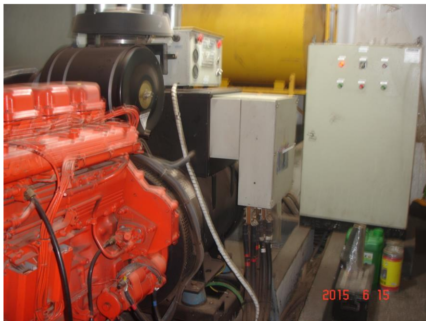
Vista GRUPO GERADOR A DIESEL composto por Gerador WEG, modelo 311AVS, potência 108 KVA e motor SCANIA, modelo DC12 60A. Patr. 00337
