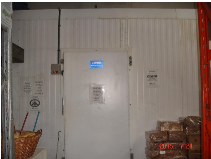
Vista do SISTEMA DE RESFRIAMENTO, composto por 03 CÂMARA FRIAS Patr. 1777
