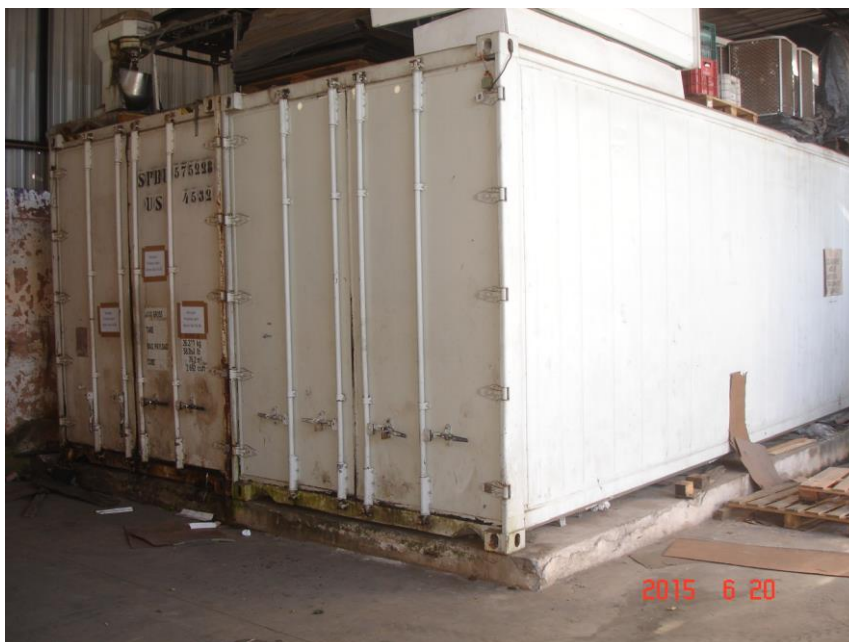
Vista das CÂMARAS FRIAS DE CONGELADOS E RESFRIADOS(CONTAINER) . Patr. 00470 e 00471
