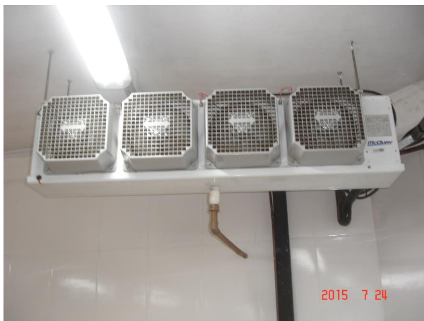
Vista do EVAPORADOR COM 04 VENTILADORES, marca MACQUAY, Patr.1744
