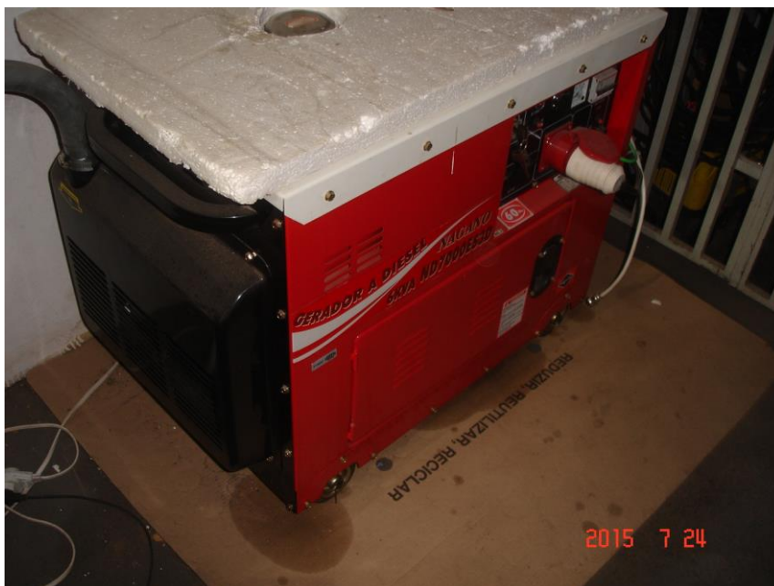
Vista do GERADOR A DIESEL, marca NAGANO, modelo ND700ES3D, capacidade 6 KVA, Patr. 1779
